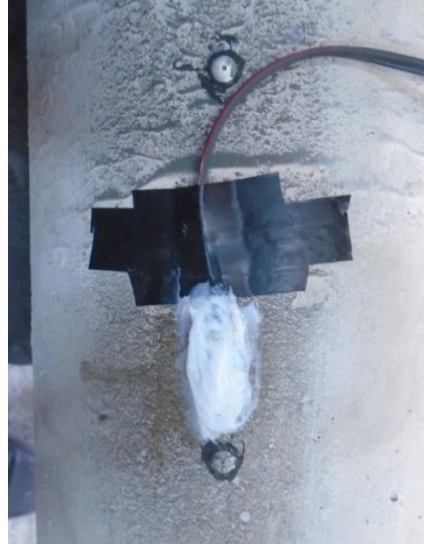
شکل (۷) تصویری از نصب حسگرهای الکتریکی و مکانیکی بر سطح بتن ستون
