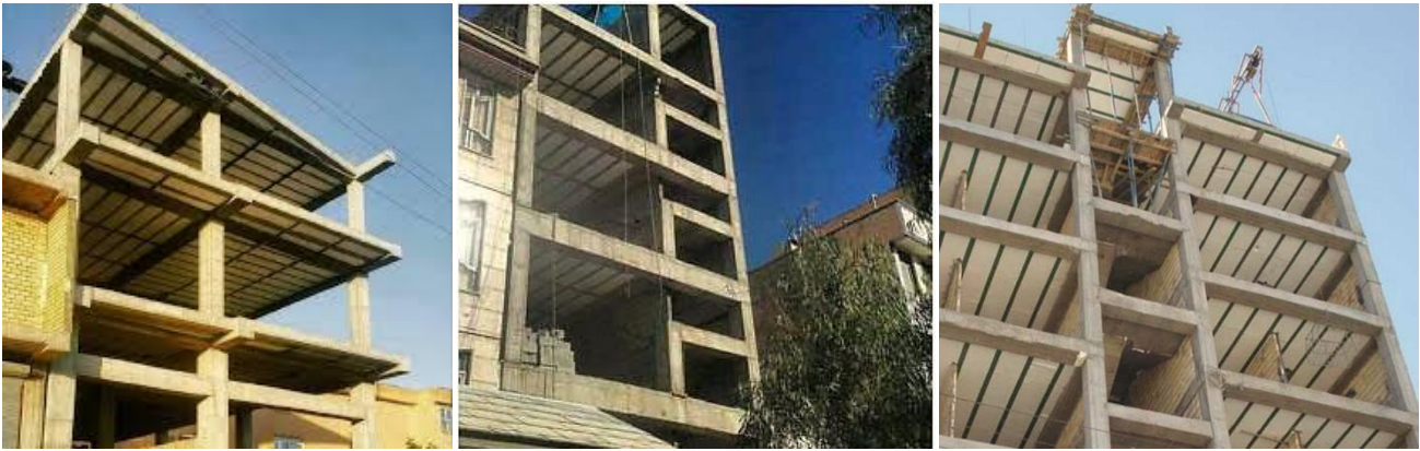
شکل ۱ علق بروز ستون کوتاه در برخی از ساختمان‌ها [۵، ۳]
