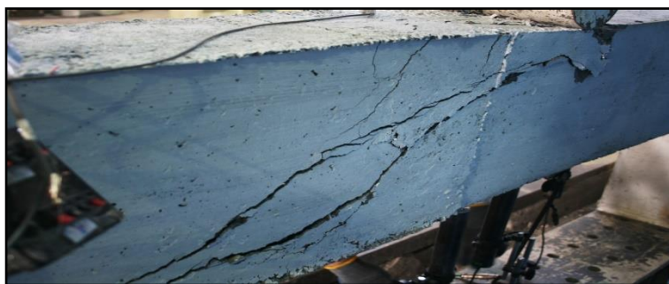
شکل ۱۰: الگوی ترک خوردگی پشت تیر ST-NC
