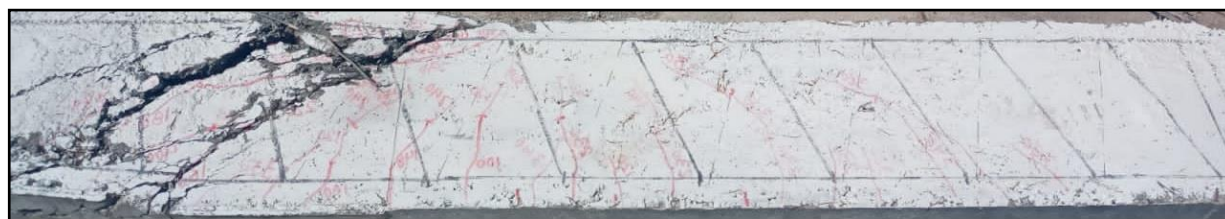
شکل ۱۲: الگوی ترک خوردگی پشت تیر SP-0.75
