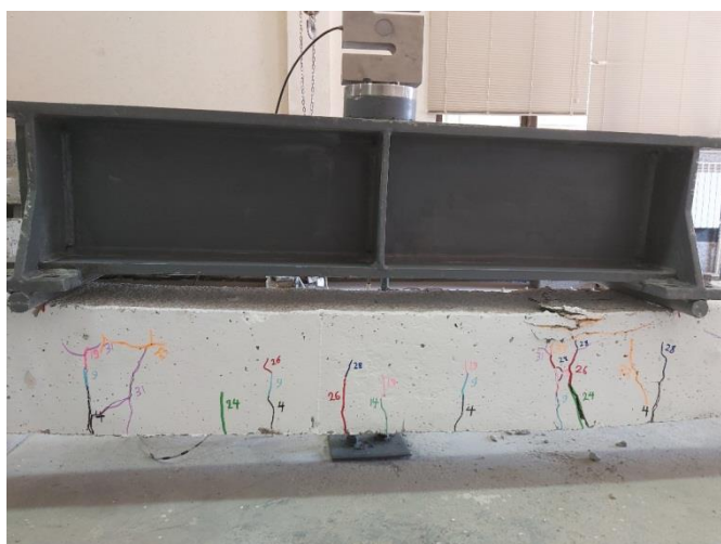
شکل ۶، تیر بتن مسلح تقویت نشده بعد از بارگذاری
